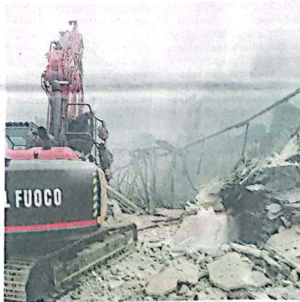
Tra le macerie. Ruspe al lavoro per individuare piccoli focolai
